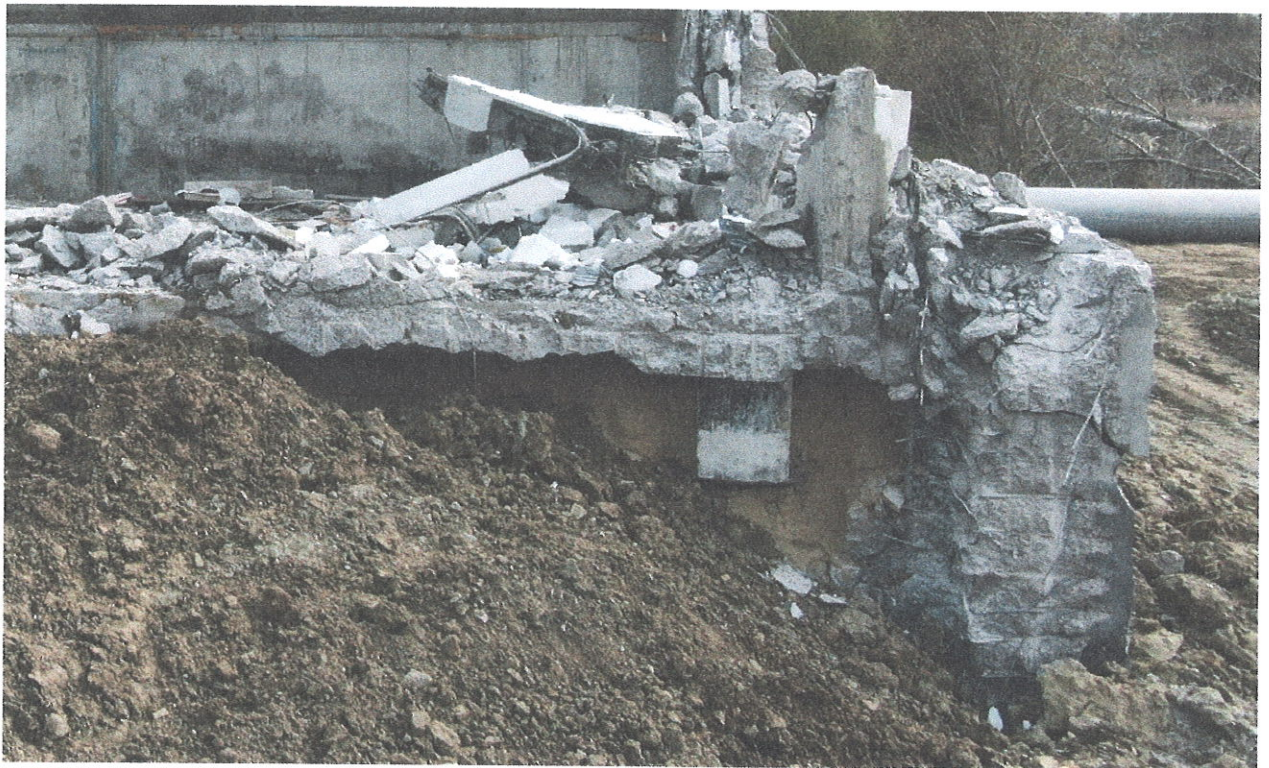
Рисунок 3.3 – Руйнування ригеля, відкритка та стінки опори 0
