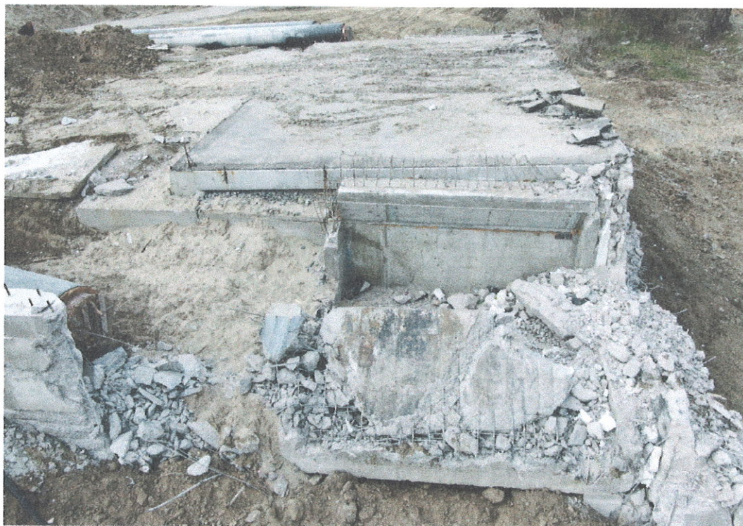
Рисунок 3.6 – Руйнування ригеля, відкритка та стінки опори 0
