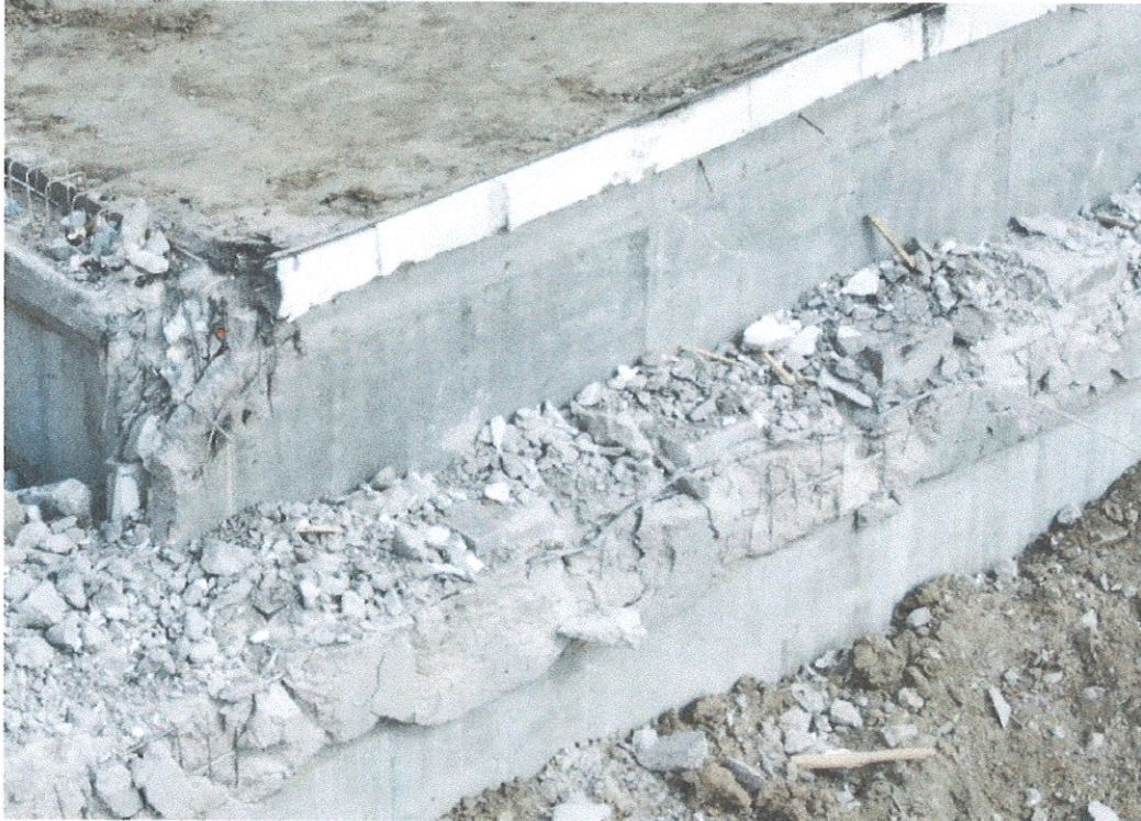
Рисунок 3.4 – Руйнування ригеля, ушкодження підфермеників опори 0
