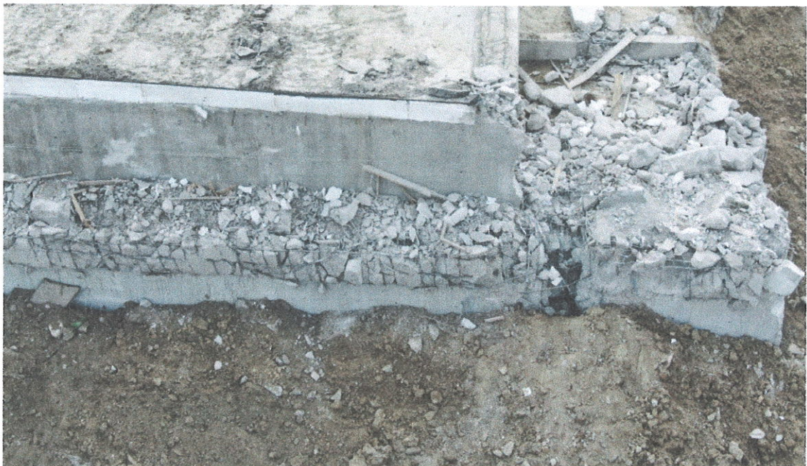
Рисунок 3.5 – Руйнування ригеля, ушкодження підфермеників опори 0
